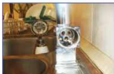
ح- کنترل نشتیگاه
