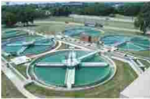
تصفیه آب در تصفیه خانه
